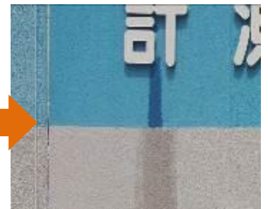
高精細画像による拡大状況 (ひび割れ幅最小0.2mm)
